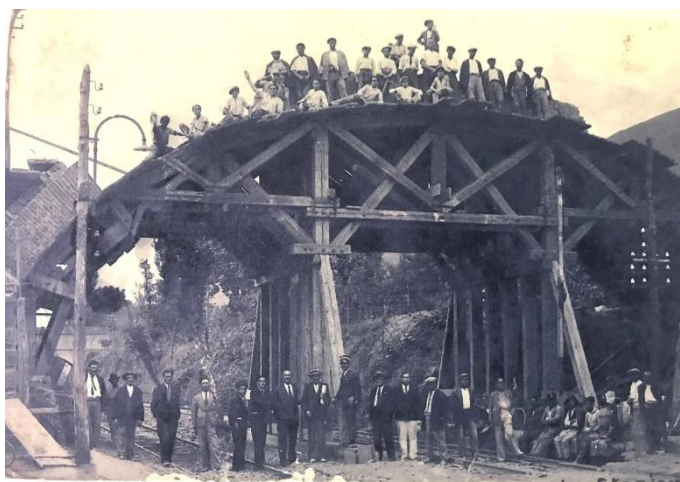
Lavori di costruzione del cavalcavia sulla ferrovia Codola–Mercato San Severino, anno 1934. Archivio Attilio Rescigno, della frazione Torello, all'epoca operaio nel cantiere.
